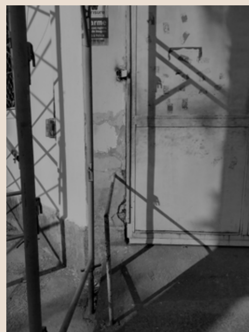
Figura 101: Descolamento de reboco e fissuras na fachada sudoeste da Igreja. Fonte: Autoria própria, 2021.
