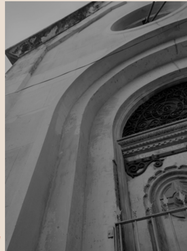
Figura 96: Danos na entrada lateral da fachada sudeste da Igreja. Fonte: Autoria própria, 2021.
