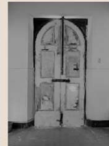
Figura 83: Danos na porta de acesso lateral. Fonte: Autoria própria, 2021.
