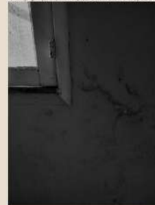
Figura 85: Danos na esquadria superior e manchas de umidade. Fonte: Autoria própria, 2021.
