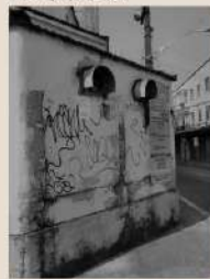
Figura 76: Descolamento de reboco, fissuras, crosta negra e pichação/grafite na fachada sudoeste da Igreja. Fonte: Autoria própria, 2021.
