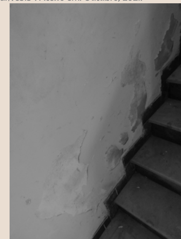
Figura 111: Descolamento de reboco na escada. Fonte: Autoria própria, 2021.
