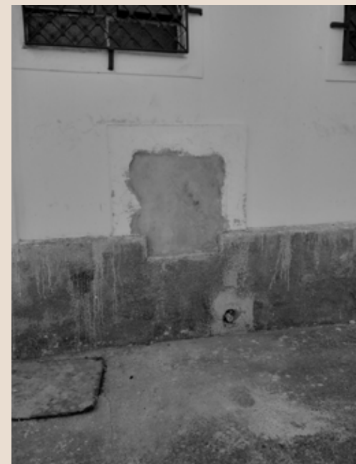
Figura 92 Vedação de instalação na fachada sudeste da Igreja. Fonte: Autoria própria, 2021.
