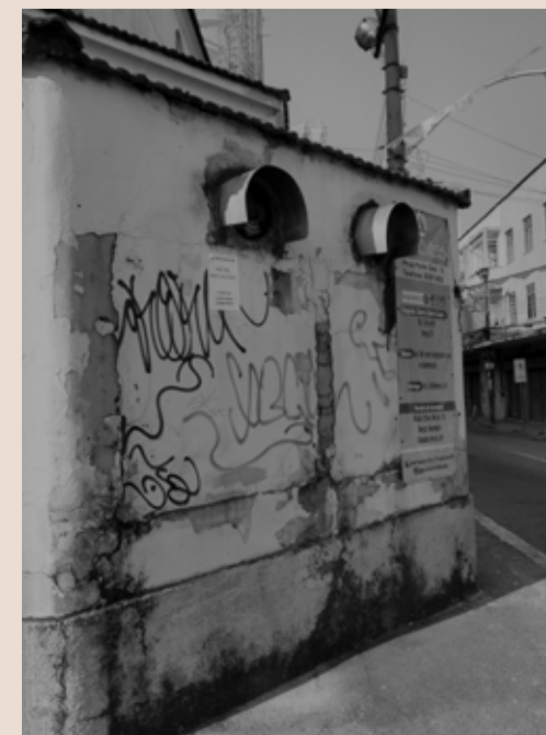
Figura 103: Descolamento de reboco, fissuras, crosta negra e pichação/grafite na fachada sudoeste da Igreja. Fonte: Autoria própria, 2021.
