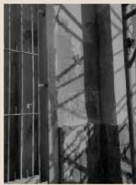
Figura 80: Descolamento de reboco na fachada nordeste da Igreja. Fonte: Autoria própria, 2021.
