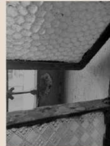
Figura 87: Descolamento de reboco na esquadria do térreo. Fonte: Autoria própria, 2021.
