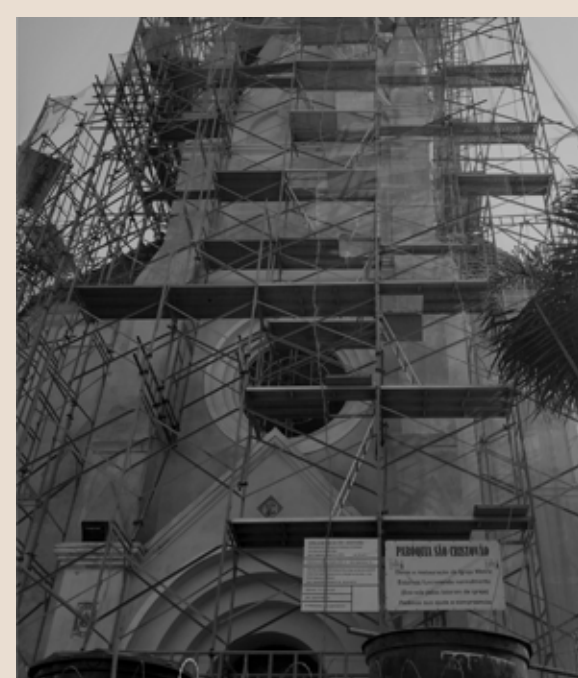
Figura 88: Manchas de umidade na fachada nordeste da Igreja. Fonte: Autoria própria, 2021.
