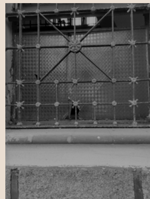
Figura 94: Vidro quebrado da esquadria na fachada sudeste da Igreja. Fonte: Autoria própria, 2021.
