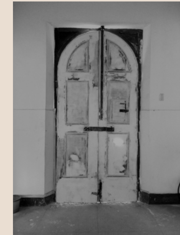
Figura 108: Danos na porta de acesso lateral. Fonte: Autoria própria, 2021.
