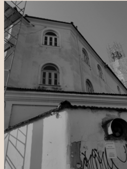
Figura 104: Manchas de umidade e fissuras na fachada sudoeste da Igreja. Fonte: Autoria própria, 2021.
