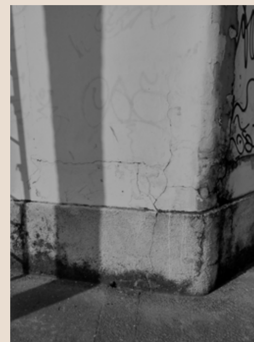
Figura 102: Fissuras/rachaduras na fachada sudoeste da Igreja. Fonte: Autoria própria, 2021.
