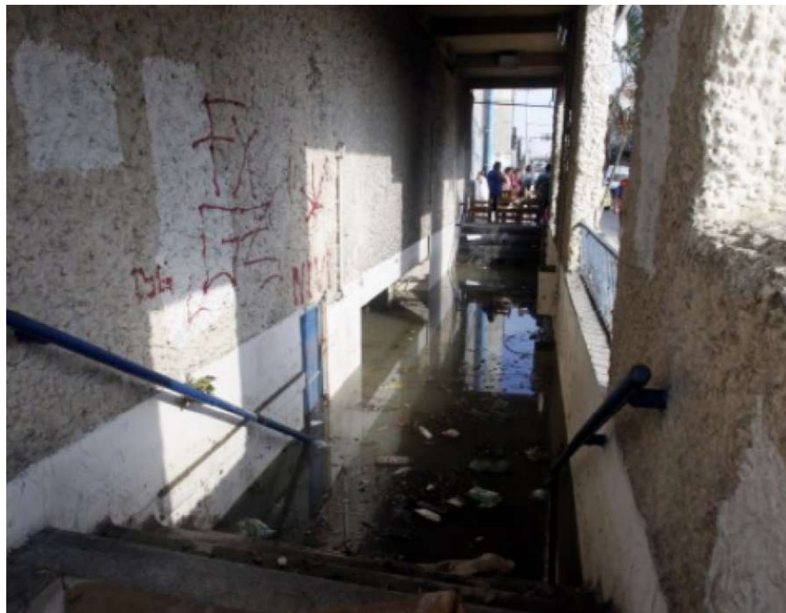
(imagem do acesso subterrâneo à estação de trem de Ramos após temporal em 15/02/2018. fonte: jornal nf notícias, acesso em 04/10/2021)
