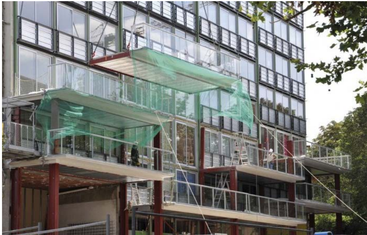
Transformação da Tour Bois le Prêtre - Paris 17 - Druot, Lacaton & Vassal (Foto Frédéric Druot) (Paris, 2011)
