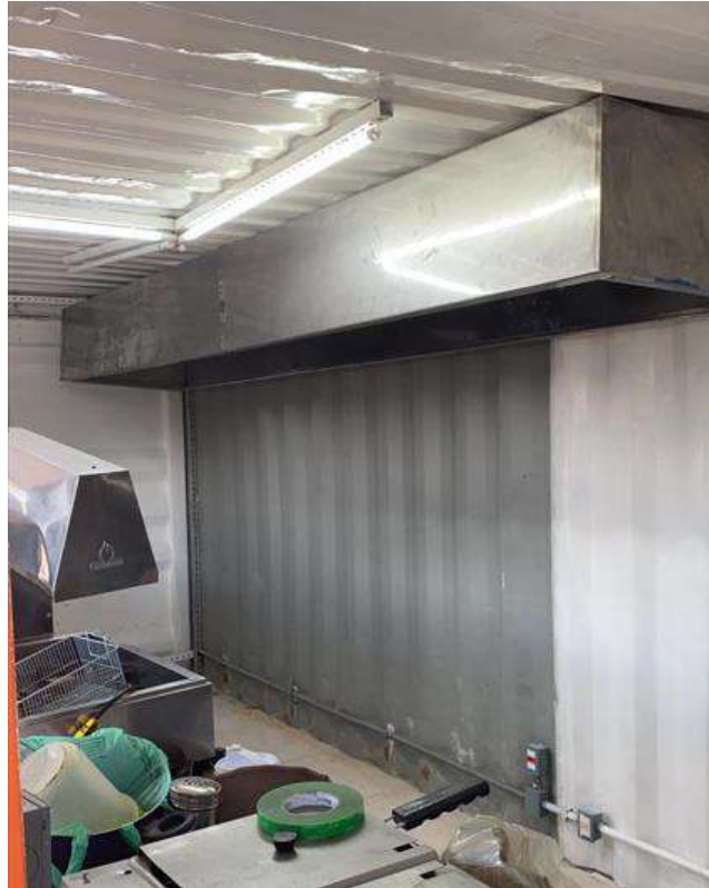
Figura 35 - Coifa instalada na cozinha
