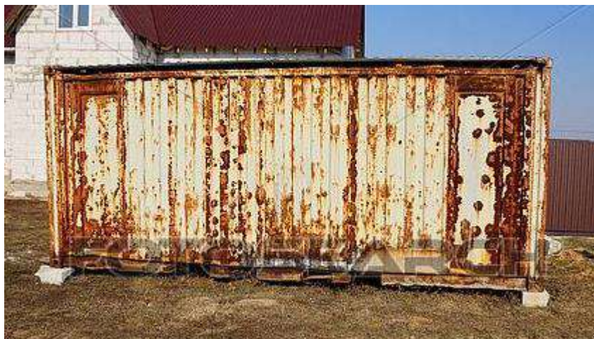
Figura 16 - Container com ferrugem nas laterais
