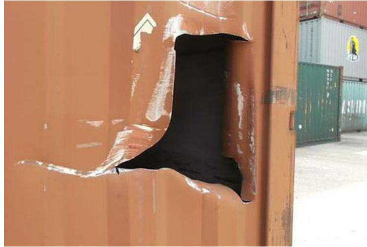
Figura 14 - Ruptura lateral em um container
