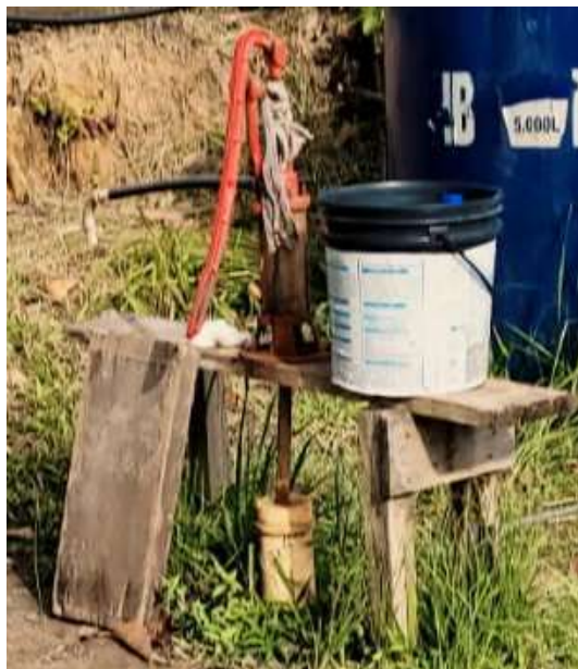
Figura 24 – Poço 1 com bombeamento manual (poço profundo)
