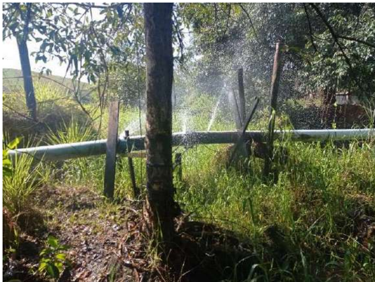
Figura 27 – Tubulação a montante da comunidade, com vazamentos nas conexões
