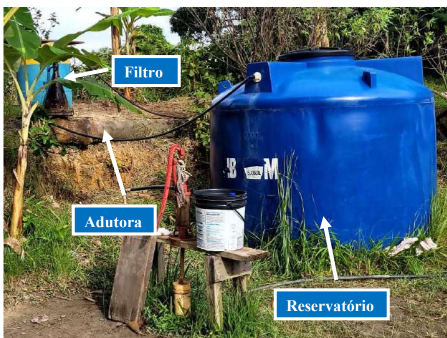
Figura 22 – Vista do sistema: barril do filtro próximo à adutora e reservatório de água tratada
