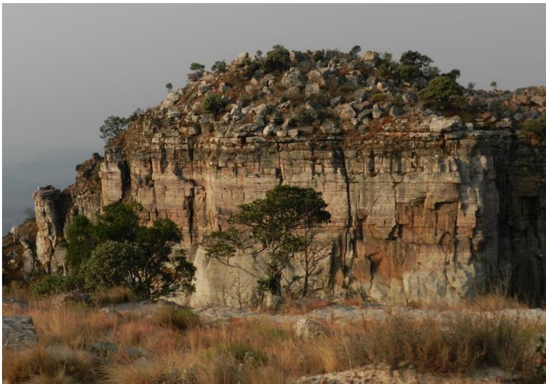
Figura 5.9: Paredão rochoso do Miradouro da Leba, constituído pelas formações siliciclásticas do Grupo da Chela. A intensa fraturação da escarpa favorece a sua instabilidade e propicia os movimentos de vertente.
