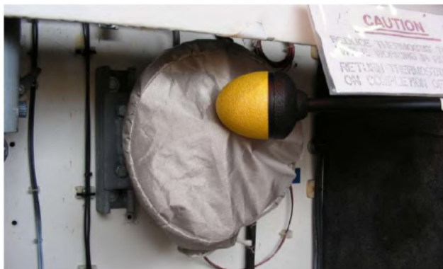
Figura 33 - Blindagem para EMI cobrindo um transmissor instalado num ambiente de sinal wireless (AMS, 2016)
