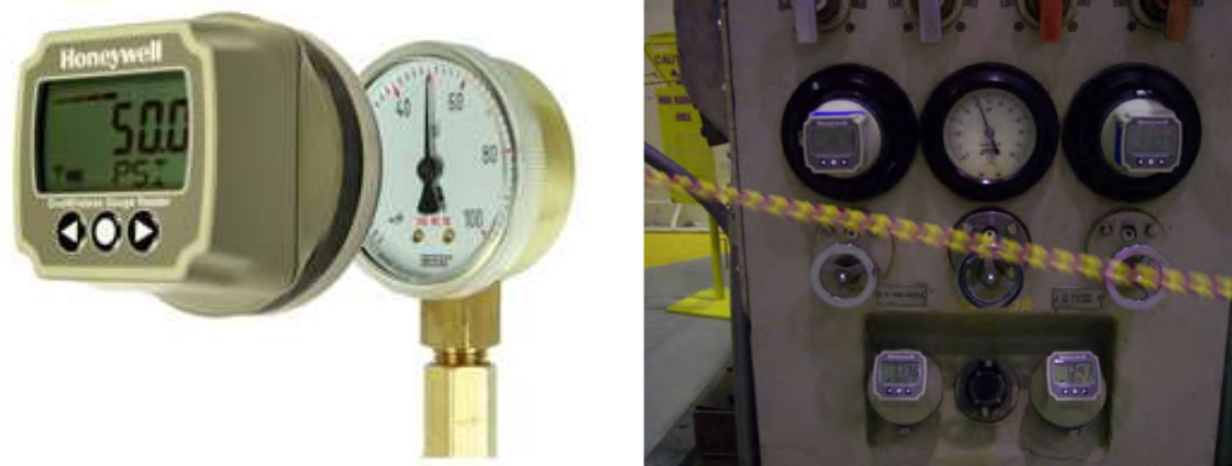
Figura 60 - Leitores de Medidores Sem Fio Honeywell (Wireless Gauge Readers) instalados em medidores na Central Nuclear Vermont Yankee. (Honeywell 2010)
