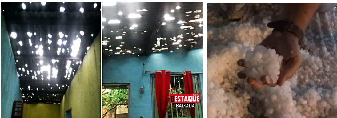
Figura 18. Checagem de ocorrência: fotos da destruição causada pela tempestade
