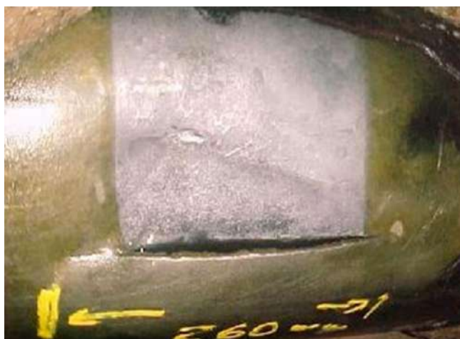
Figura 14 - Dano casado ao duto pela perfuração da empreiteira.
