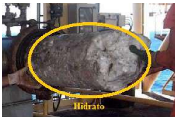
Figura II.4: Formação de hidrato em equipamento.
