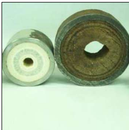
Figura 9: Tubo parcialmente obstruído por incrustação inorgânica. (Fonte: Rocha, 2002)
