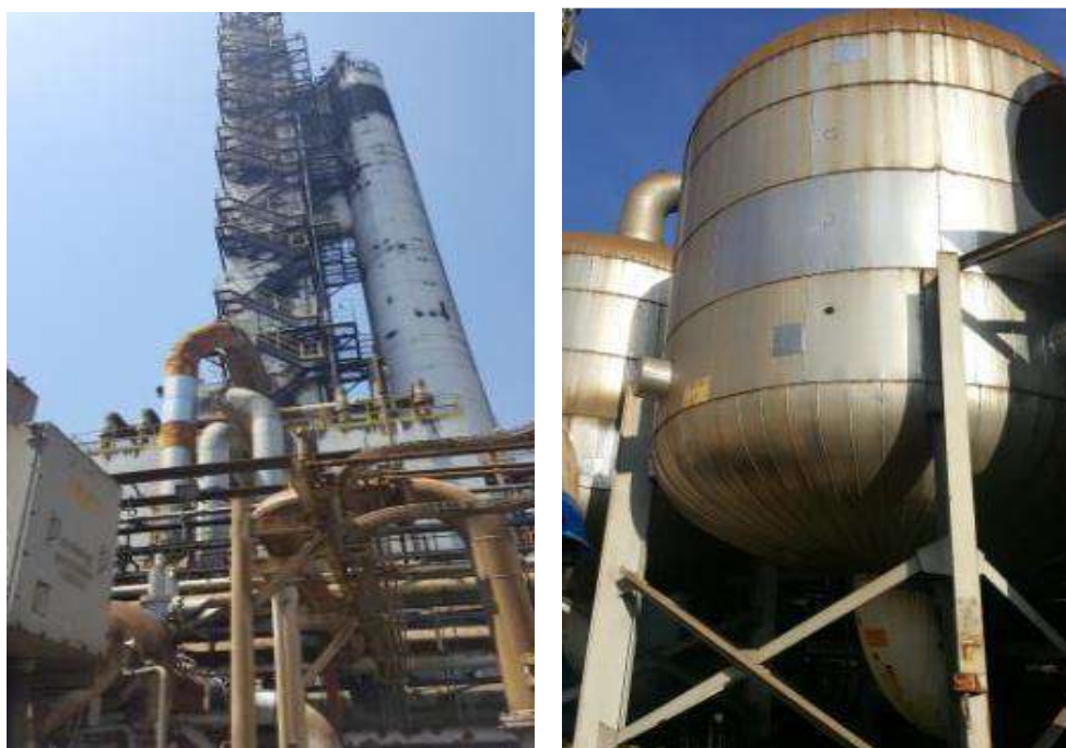
Figura 25 – Torre de destilação criogênica (esq.) e vaso de PSA (dir.). Fonte: Autora.
