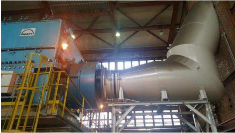
Figura 26 – Compressor de uma das plantas industriais. Fonte: Autora.
