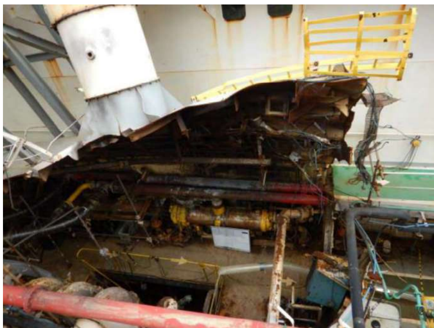
Figura 19 - Piso do deck deslocado para cima após a explosão.
