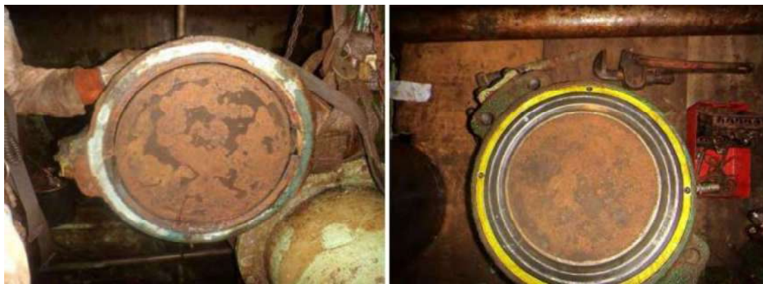
Figura 22 - Válvula do sistema de carga com selo de vedação degradado à esquerda e, à direita, outra válvula com selo de vedação substituído.
