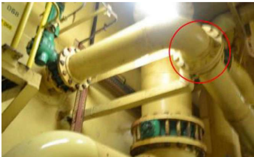
Figura 12 - Flange por onde ocorreu o vazamento (foto retirada antes do acidente).
