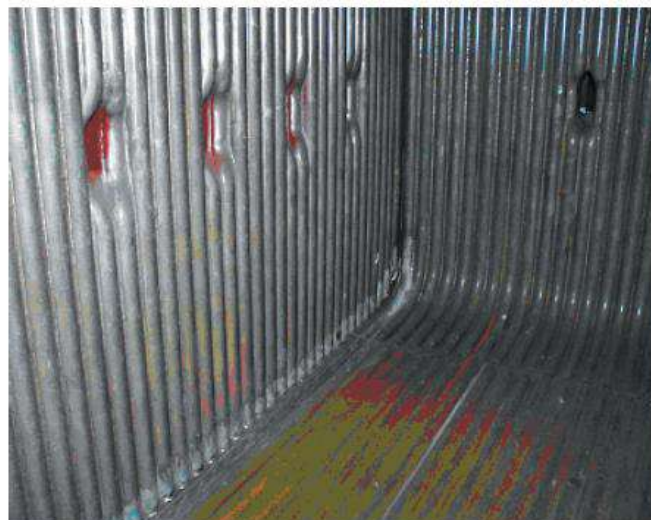
Figura 12: Interior da fornalha de uma caldeira de recuperação da Andritz com os tubos de aço-carbono. Fonte: VAKKILAINEN, 2005.
