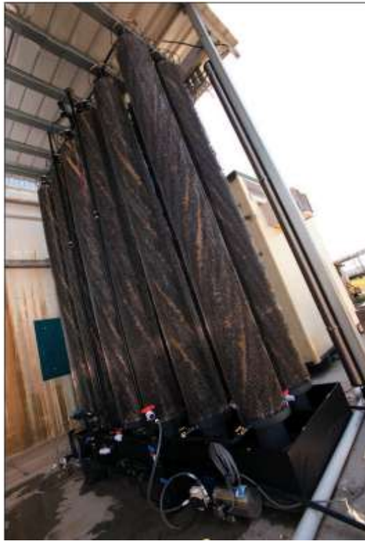
Figura V.5 - CCM em escala piloto para tratamento de efluente cervejeiro.
