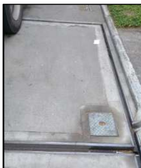
Figura 4.7 – Canaletas de drenagem oleosa. Fonte: Autor
