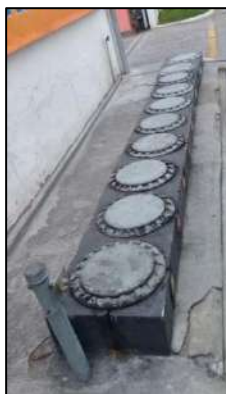
Figura 4.8 – Respiros dos tanques e pontos de descarga à distância. Fonte: Autor
