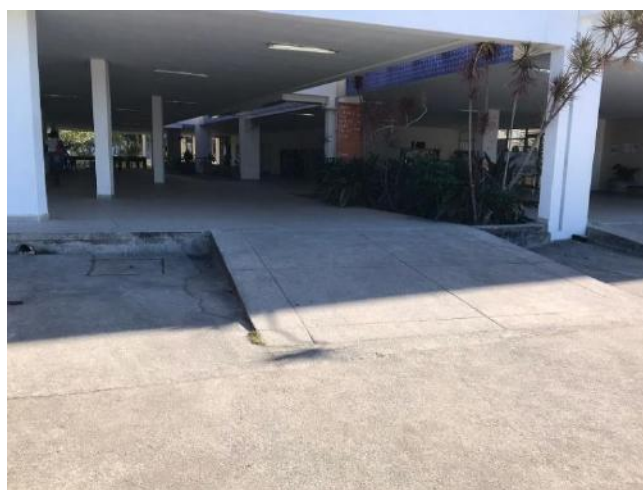
Figura 91 - Ausência de corrimão na rampa (Autor, 2023)
