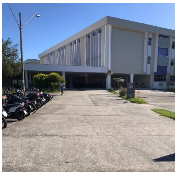
Figura 89 - Falta de piso tátil (Autor, 2023)
