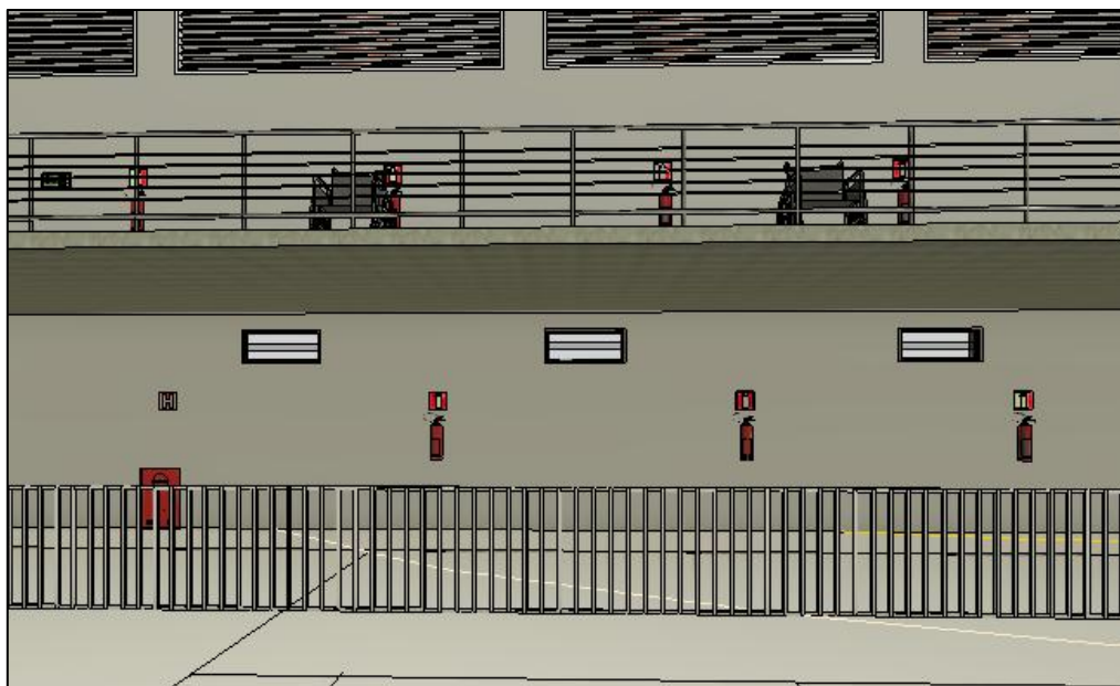
Figura 109 - Sinalização contra incêndio (Autor)
