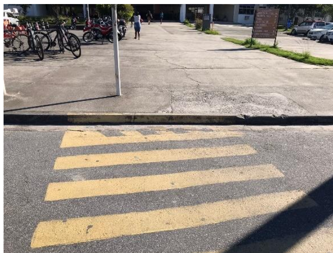
Figura 90 - Falta de rampa para acesso a calçada (Autor, 2023)
