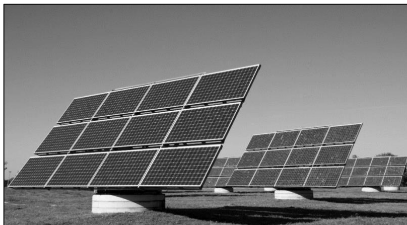
Figura 13 – Sistema de painéis solares
