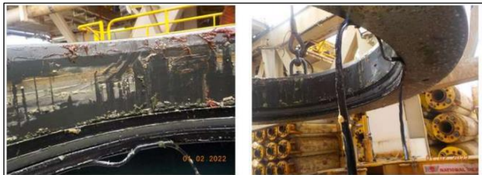
Figura 29 - Danos ao selo da câmara de open
