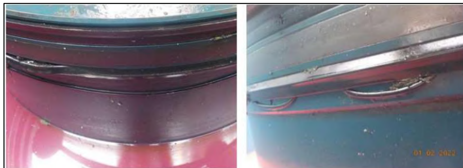
Figura 27 - Danos ao selo da câmara de close (2)
