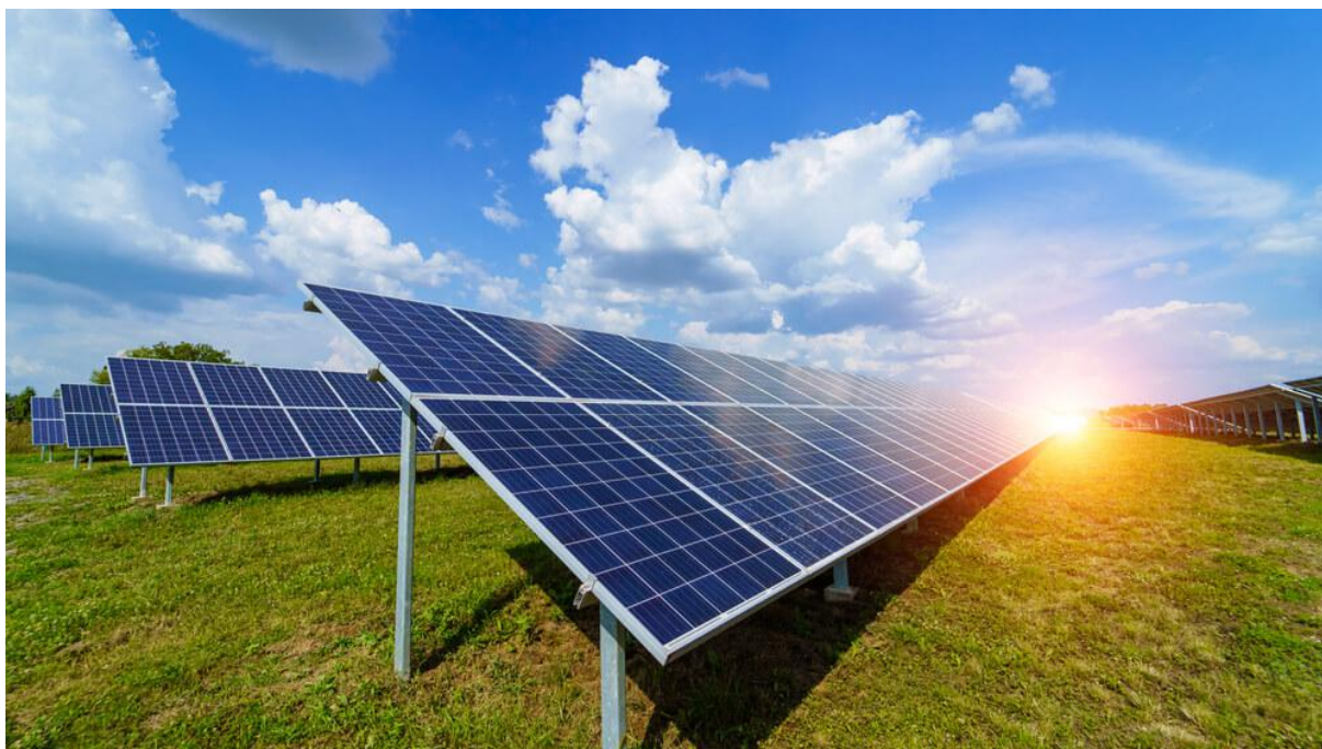
Figura 1 – Usina solar fotovoltaica
