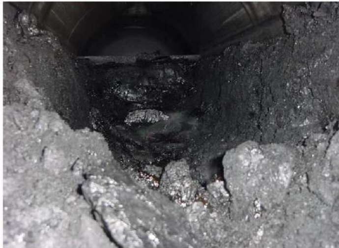
Figura II.6 Precipitado de asfalteno depositado em uma tubulação (YEN, 2009)
