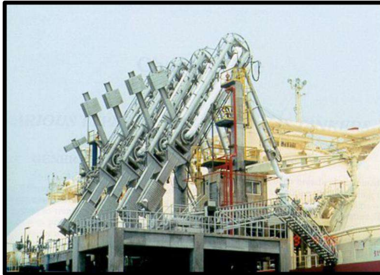
Figura 9 - Braços articulados de descarregamento Fonte: GIIGNL, 2010
