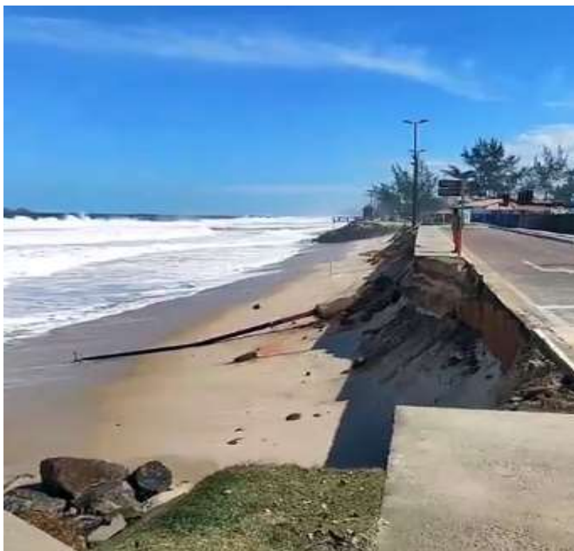
Foto 5: Deck de acesso à praia destruído na praia da Barra de Maricá na ressaca de julho de 2021. Fonte: MARICÁ INFO
