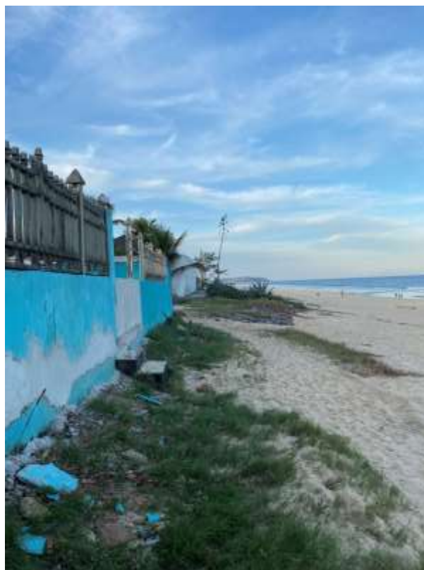
Foto 9: Casa posicionada no topo da escarpa de erosão, rua 93, Praia do Cordeirinho. Fonte: De autoria própria (2023).
