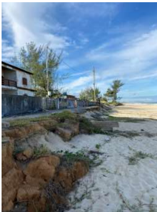
Foto 12: Marcas de erosão costeira após as ressacas de julho de 2021, na praia de Cordeirinho.
