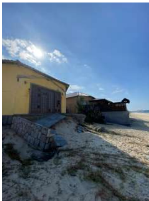
Foto 2: Muro da casa destruído e remoção da restinga da praia após a ressaca de julho de 2021 na Praia de Ponta Negra. Fonte: De autoria própria (2023).
