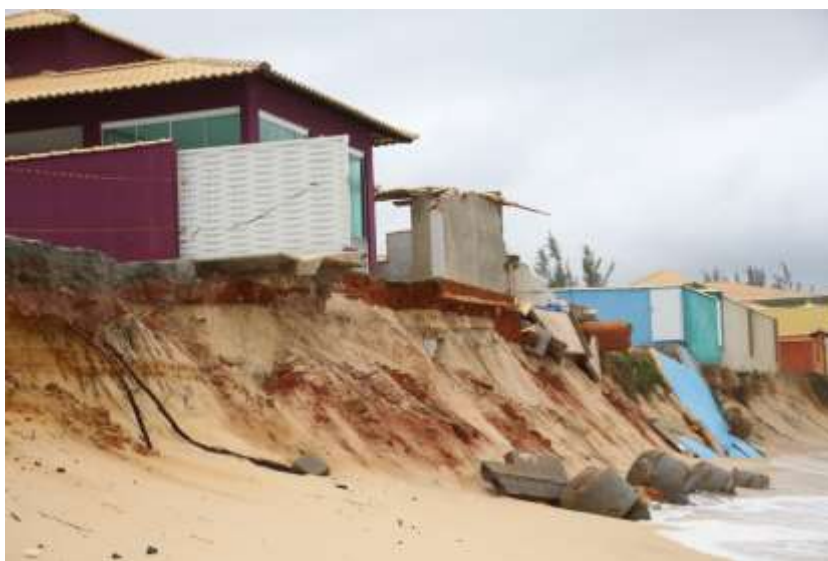
Foto 8: Destruição de muros, calçada e danos às casas na região de cordeirinho entre as ruas 64 e 65 após a ressaca do mar de 2019. (Fonte: Maricá info, 2019)
