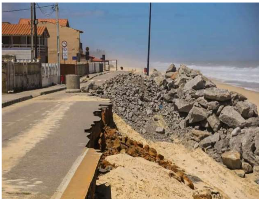
Foto 3: Calçada e rua parcialmente destruídas na praia da Barra de Maricá após a ressaca de julho de 2021. Fonte: JORNAL ENFOCO
