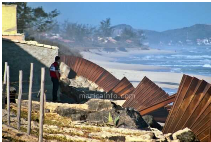
Foto 7: Estacas-prancha danificadas na praia de Guaratiba após as ressacas do mar de julho de 2021. Fonte: MARICÁ INFO.
