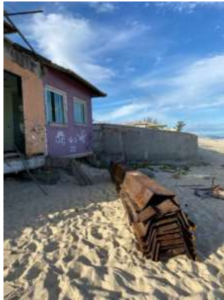
Foto 10: Casa na rua 64, em Cordeirinho, que teve grande parte de sua estrutura danificada e o muro completamente destruído após a ressaca de 2019. Nessa região foi utilizada a técnica de estacas-prancha para conter o avanço do mar. Com ressaca de julho de 2021 o mar retirou as estacas e elas estão até hoje empilhadas no local. Fonte: De autoria própria (2023).
