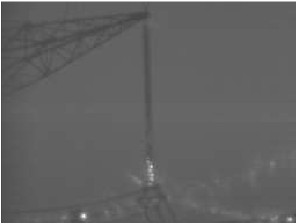
Figura 2.2: Efeito corona nas linhas de transmissão e eletrodo energizado da cadeia de isoladores.
