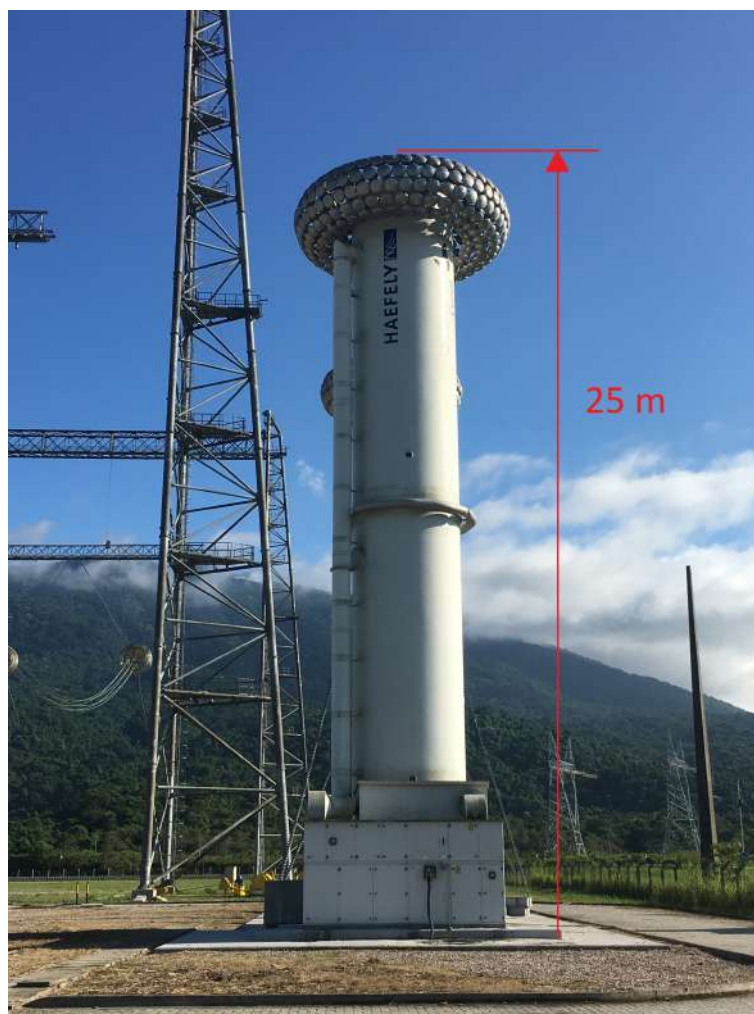
Figura 3.7: Gerador de impulsos
