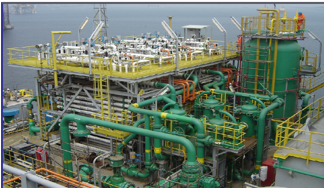
Figura 2.15: Fotografia de uma URS em plataforma offshore .
