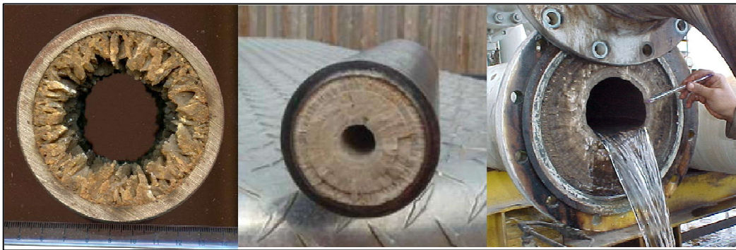
Figura 2.10: Incrustações em tubulações.
