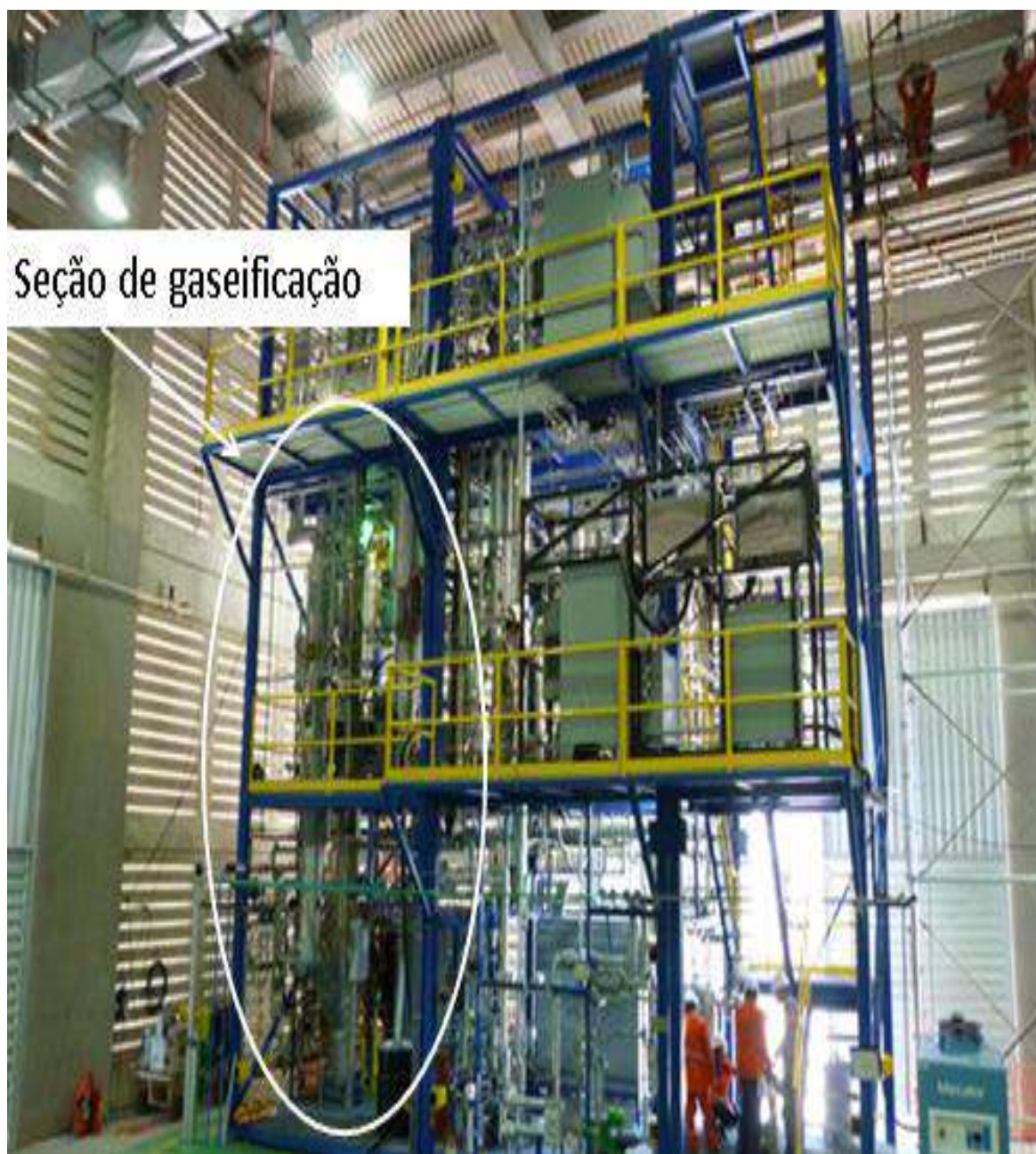
Figura 5.3. Fotografia da planta de gaseificação de biomassa da PETROBRAS.
