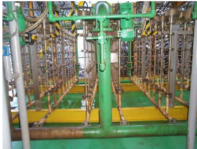
Figura 14: Liners de um Hidrociclone numa unidade Offshore Fonte: Prestadora de Serviço no Setor de Óleo e Gás, 2007
