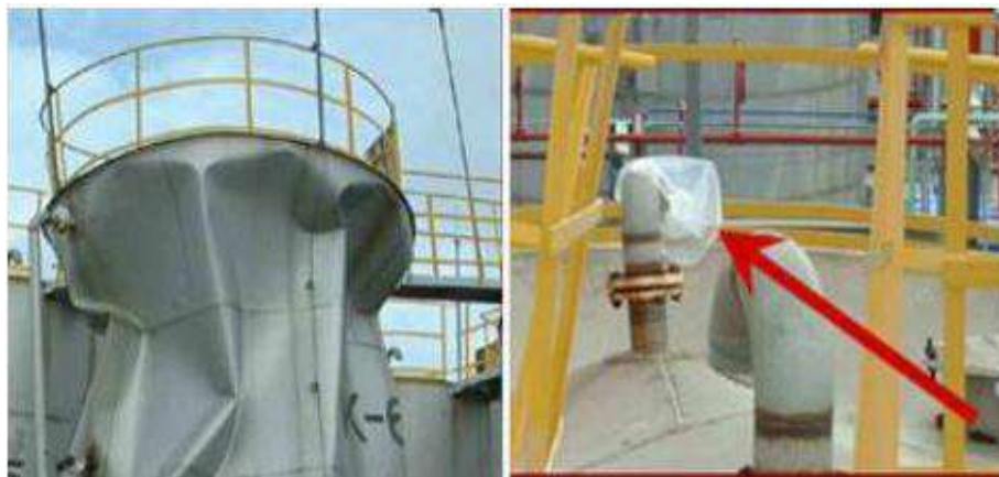
Figura 4.5: Tanque que sofreu colapso por vácuo devido ao vent bloqueado por um filme plástico.
