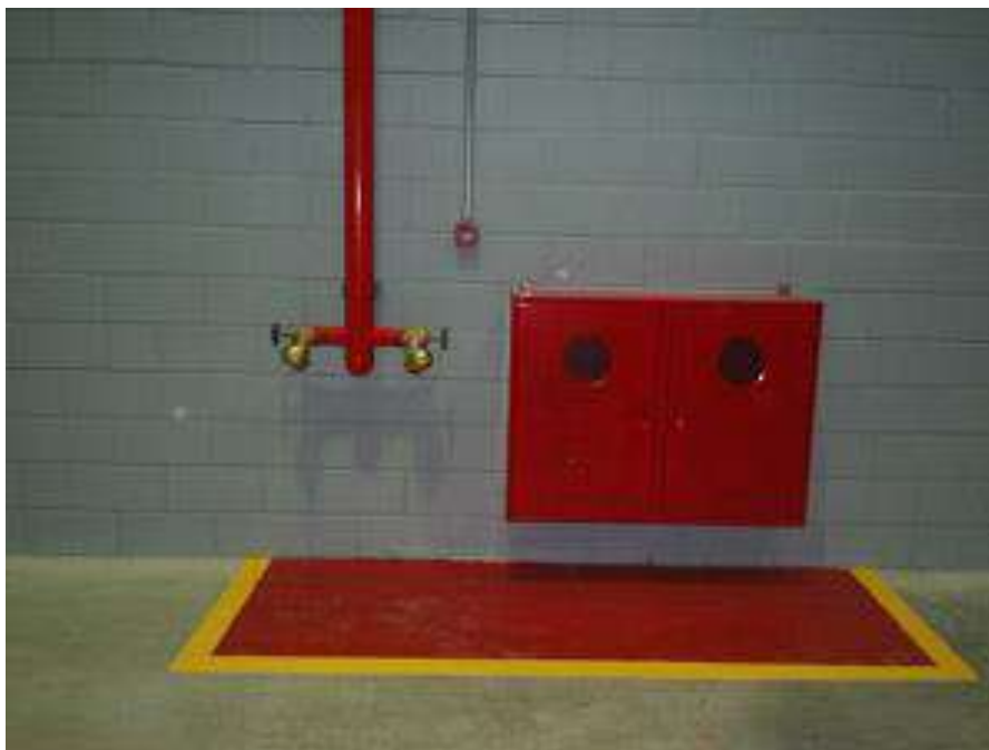
Figura 24 – Instalação Completa de Sistema de Hidrantes e Alarme de Incêndio em uma instalação industrial. Fonte: http://www.protecmontagens.com.br/fobras.html
