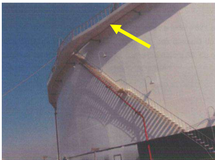
Figura 3.15: Escada e anel de contraventamento TQ 1007 Fonte: Lemmers,P.H, 2011.
