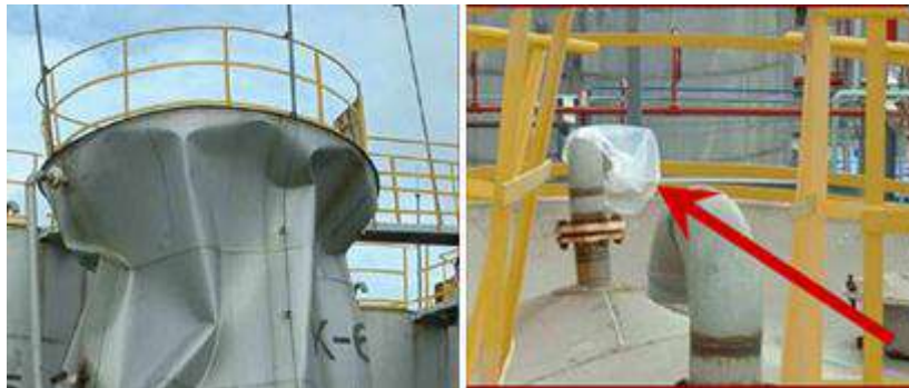
Figura 3.5 - Colapsado em função do bloqueio do respiro por um plástico.
