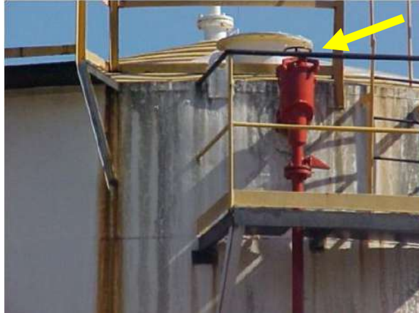
Figura 3.10: Sistema de Espuma Fonte: Petroflex,2012.
