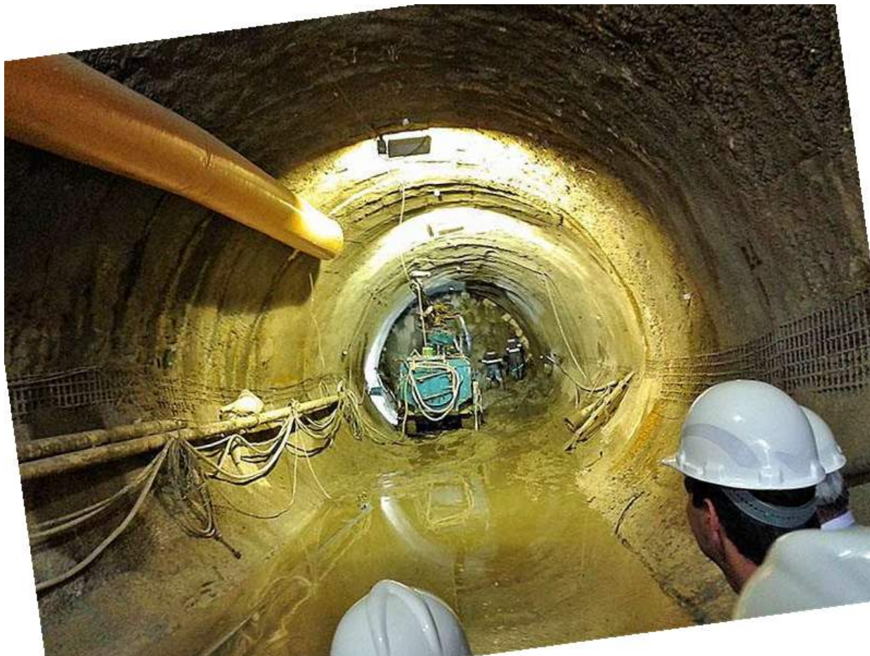
Obra de construção de reservatório de água pluvial para amortecer eventos extremos de chuva, município do Rio de Janeiro (RJ). Foto: Carlos Eduardo Young
