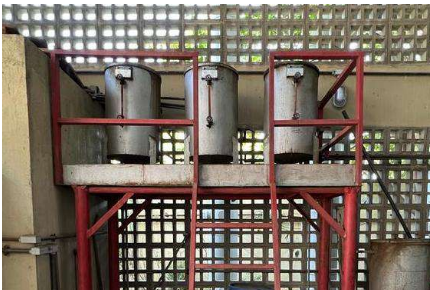
Figura 8 – Tanques de armazenamento de diesel
