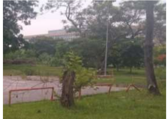
Figura 84- Exemplo de ordenador de fluxo de veículos precário
