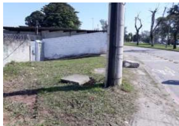
Figura 82 - Exemplo de caixa de inspeção de redes danificada
