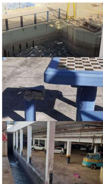
Figura 4 - Problemas no Complexo Esportivo da Rocinha.
