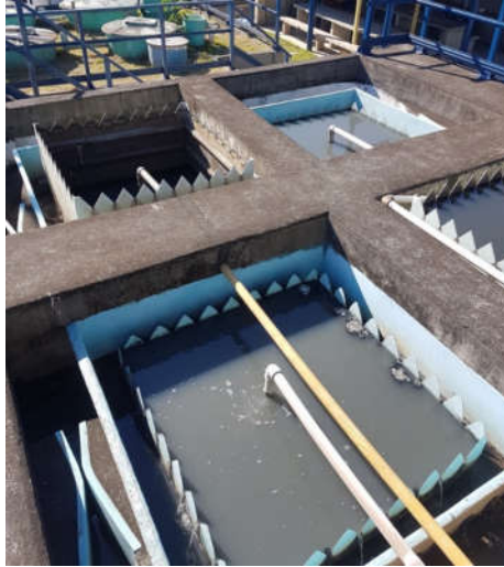
Figura 12 - Sistema de decantação primária do CESA UFRJ
