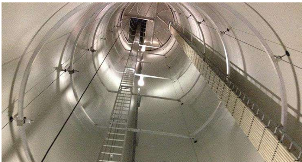
Figura 2-20. Interior de uma torre de TEO [27] .
