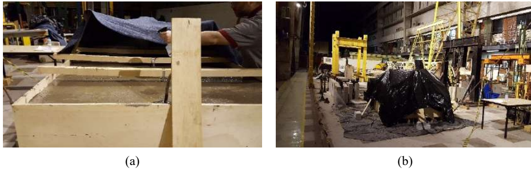
Figura 5.27 – Preparação para cura úmida: (a) Umidificação da superfície por aspersão e (b) Peça protegida com mantas úmidas e lonas.
