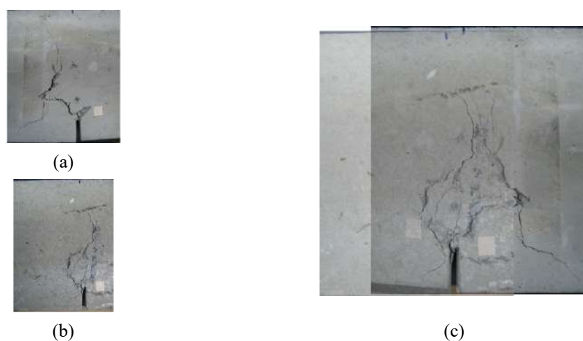
Figura 6.35 – Assimetria do padrão de fissura em corpos de prova prismáticos com dimensões 15x15 x 55cm 3 : (a) frente do corpo de prova, (b) verso do corpo de prova, e (c) sobreposição das fissuras..
