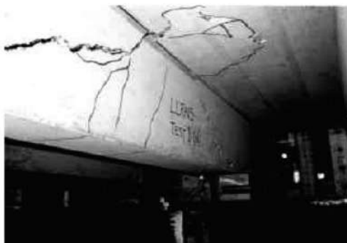
Figura 2.25 – Ruptura por esforço cortante em tabuleiro de ponte [116].
