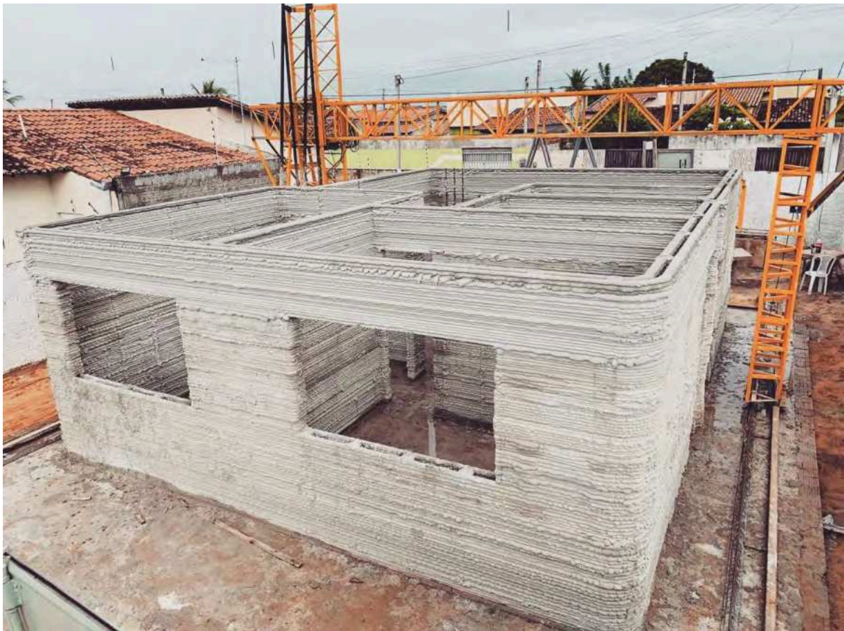
Figura 143 - Primeira casa impressa em 3D com tecnologia brasileira Fonte: Inova House 3D
