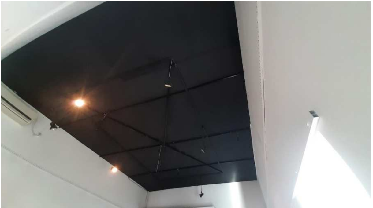
Figura 80 - Iluminação da galeria.
