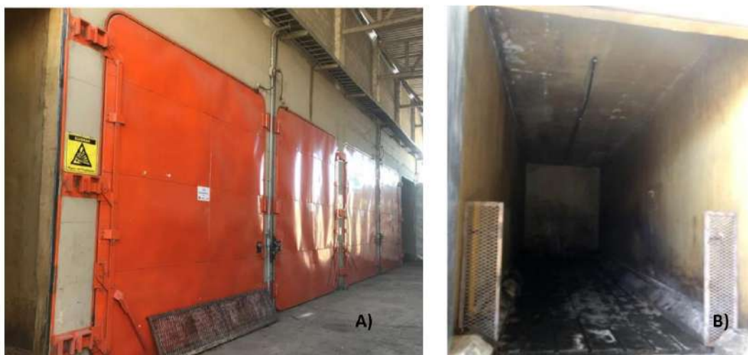
Figura 2.12 (A) Vista Externa do Biodigestor MESB; (B) Vista Interna de Biodigestor sem Resíduos Sólidos Orgânicos.
