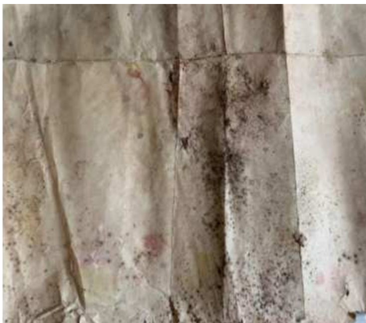
Figura 34 - Detalhamento de diferentes deteriorações. (foto da autora, 2019)
