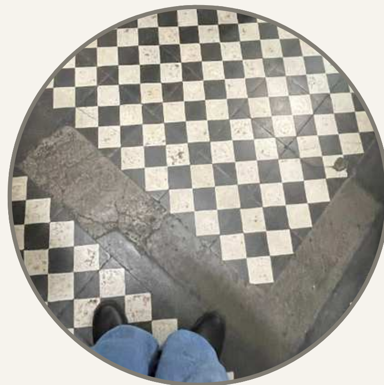
Ladrilho mal- conservado
