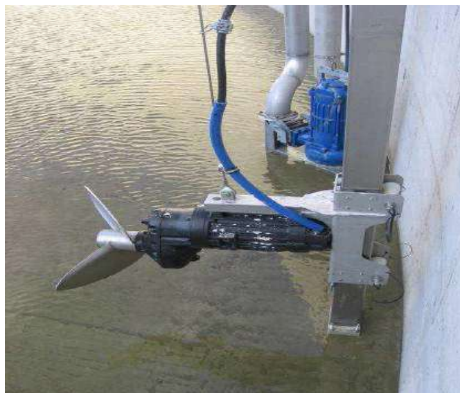
Figura 11: Agitador de motor submersível (Al SEADI, 2008).
