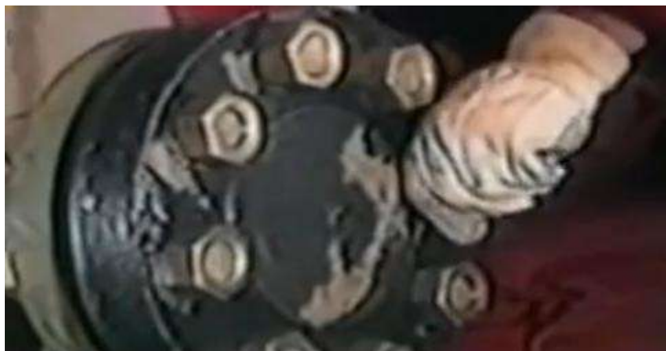
Figura VI.2 – Disco metálico (flange) aparafusado à extremidade de tubulação após retirada da PSV 504
