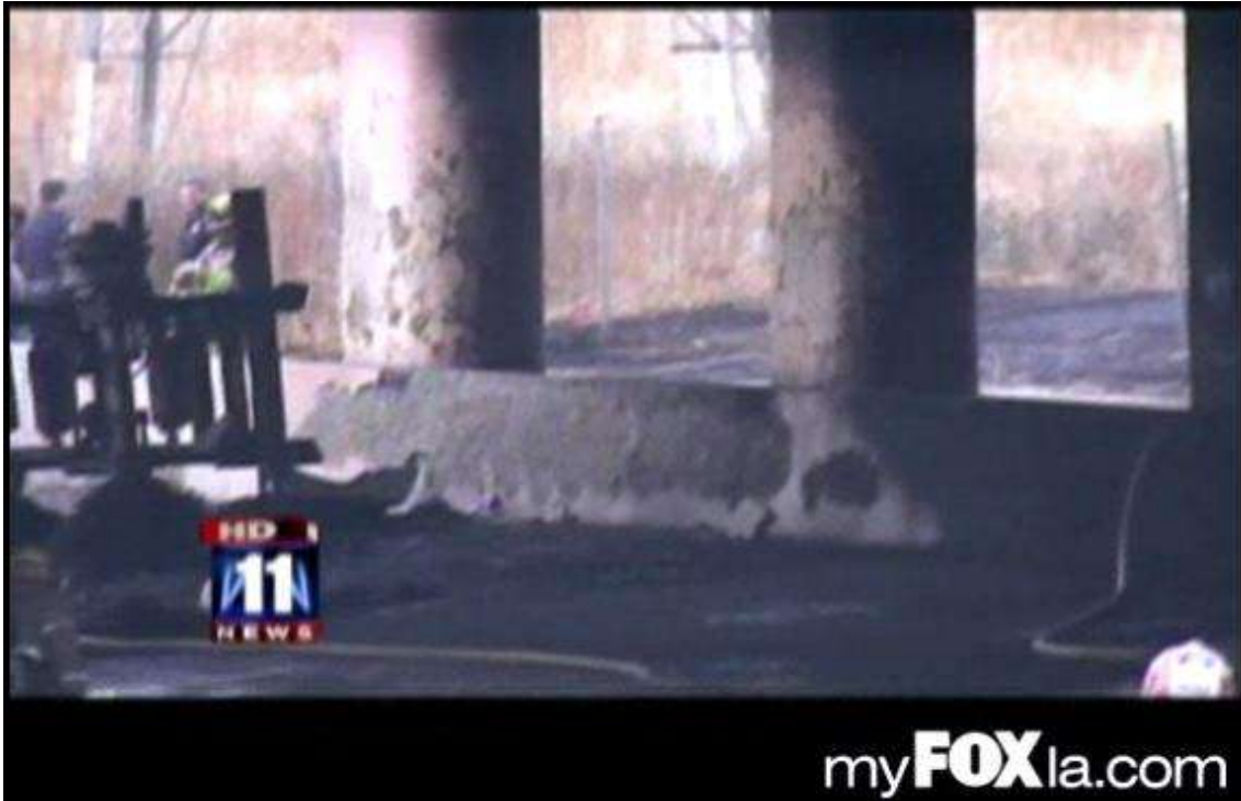
Figura 2-15: Base do viaduto comprometida devido ao intenso calor gerado pelo incêndio. Fonte: LIVE LEAK, 2009.
