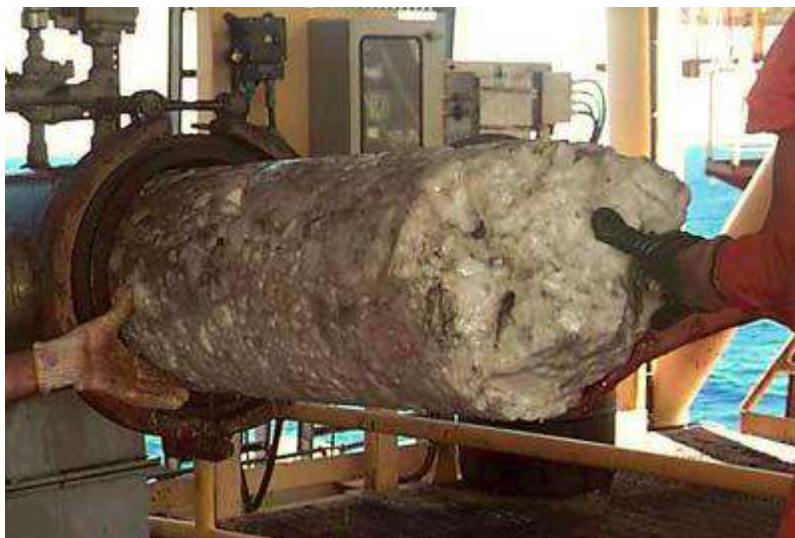
Figura 2 – Remoção de hidrato do interior de uma tubulação
