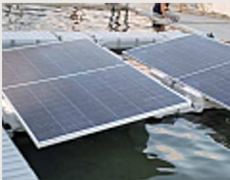
Fig. 2 – Flutuante usado em usina solar flutuante
