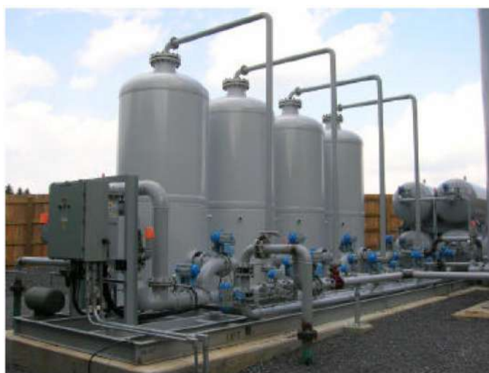
Figura II.11, Instalação de uma unidade de remoção de nitrogênio molecular gate (MITARITEN, 2009)
