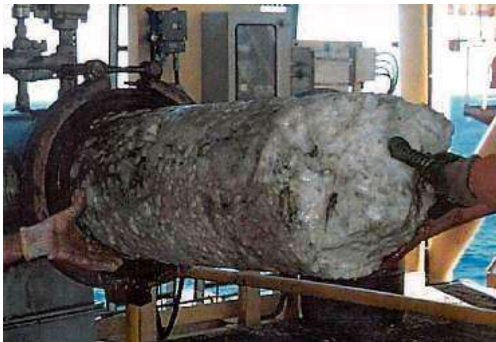
Figura 6 - Clatrato formado na tubulação de gás (PETROBRÁS)
