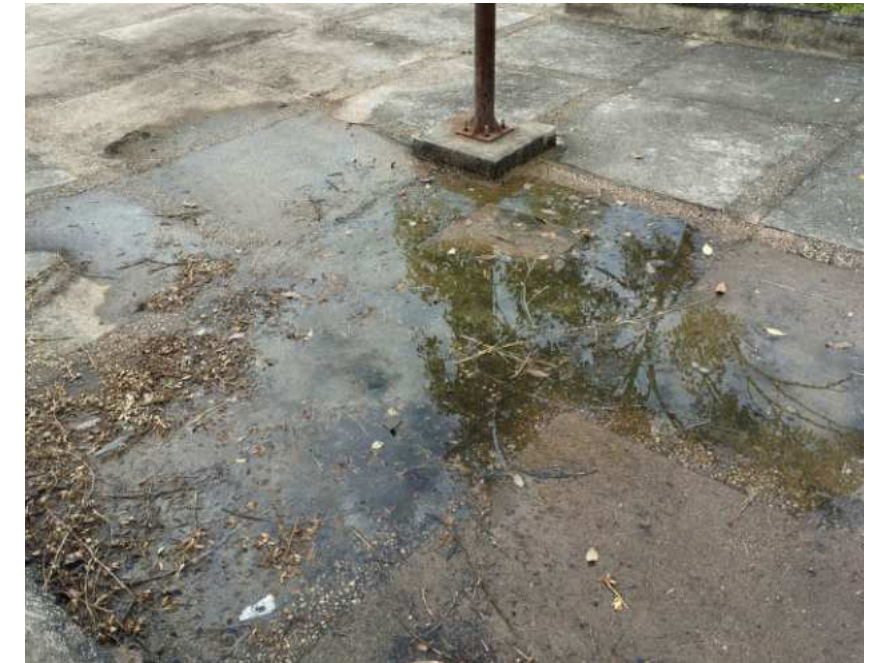
Visada 2: local com mal drenagem de água
